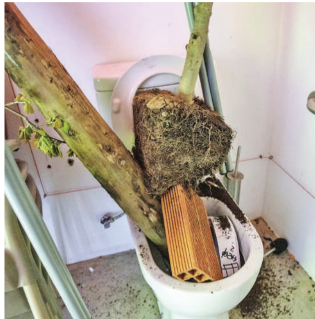
Danos causados em equipamentos de uso público
