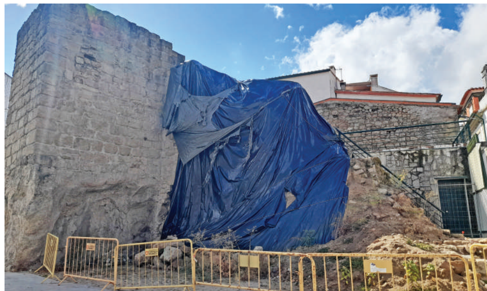
A queda do pano da Muralha causou prejuízos numa viatura estacionada
